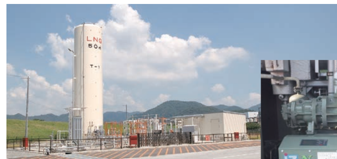
岡山総社工場のLNG用タンク
