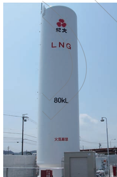
静岡工場のLNG用タンク
