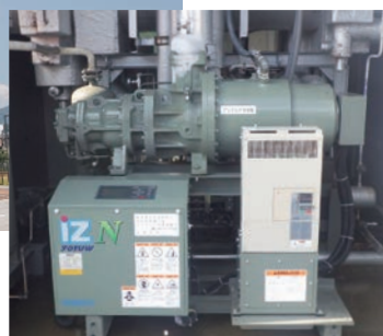
自然冷媒としてアンモニアを使用した冷凍機
