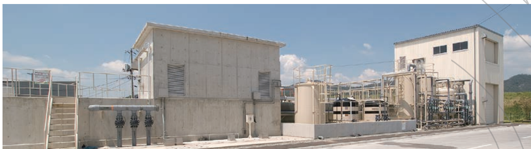
岡山総社工場の高度排水処理施設
